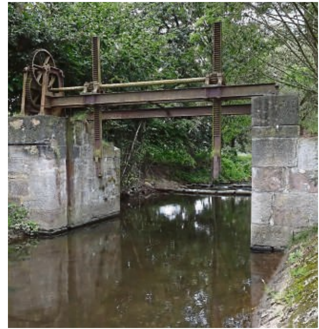
Die Schwelle am Wehr ist ebenso verschwunden wie der Absturz und das Tosbecken dahinter. FOTOS: THOMAS THIELE
